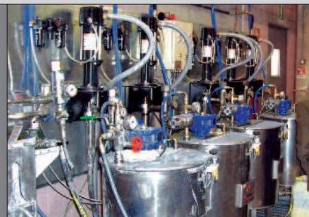
Bombas de pistón de 2 bolas, de relación 11:1, usadas en un proceso de recirculación de pintura.
