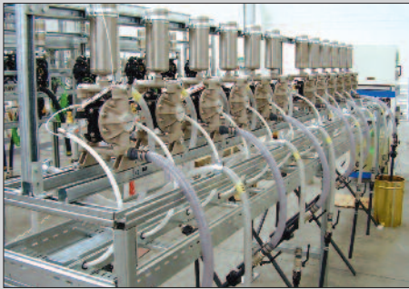
Bombas de membrana de 1/2" montadas en un sistema de formulación de tinta.
