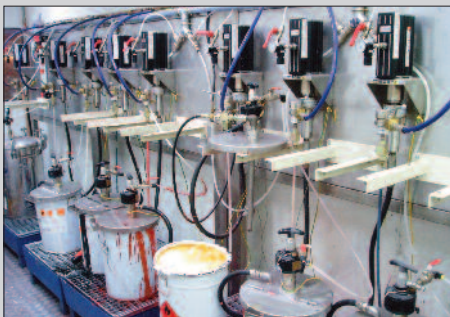
Bombas de pistón de 2 bolas, de relación 4:1, usadas en un proceso de fabricación de pintura.
