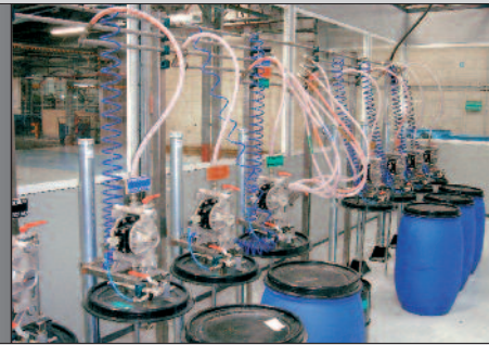
Bombas de membrana de 1/2" instaladas en un proceso de coloración.
