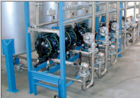
Bombas de membrana de 1 1/2" en aluminio, instaladas en la alimentación de un reactor química.
