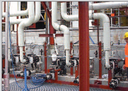
Bomba de diafragma de 2" en acero inoxidable montada con amortiguador de pulsaciones en PVDF para descarga de ácido fluorhídrico.
