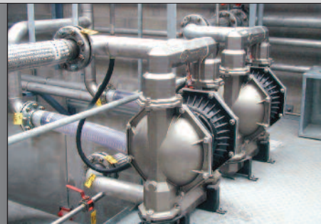
Bombas de membrana de 3" en inoxidable instaladas en un proceso de transferencia.
