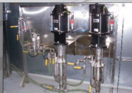
Bombas de pistón de 4 bolas, de relación 4:1, instaladas en un proceso de formulación de pintura.
