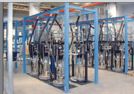
Bombas de extrusión, de relación 13:1, instaladas en un sistema de formulación de tintas offset.
