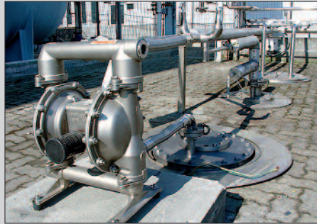
Bomba de diafragma de 1 1/2" instalada en un proceso químico para trasvasar cloruro de metileno.
